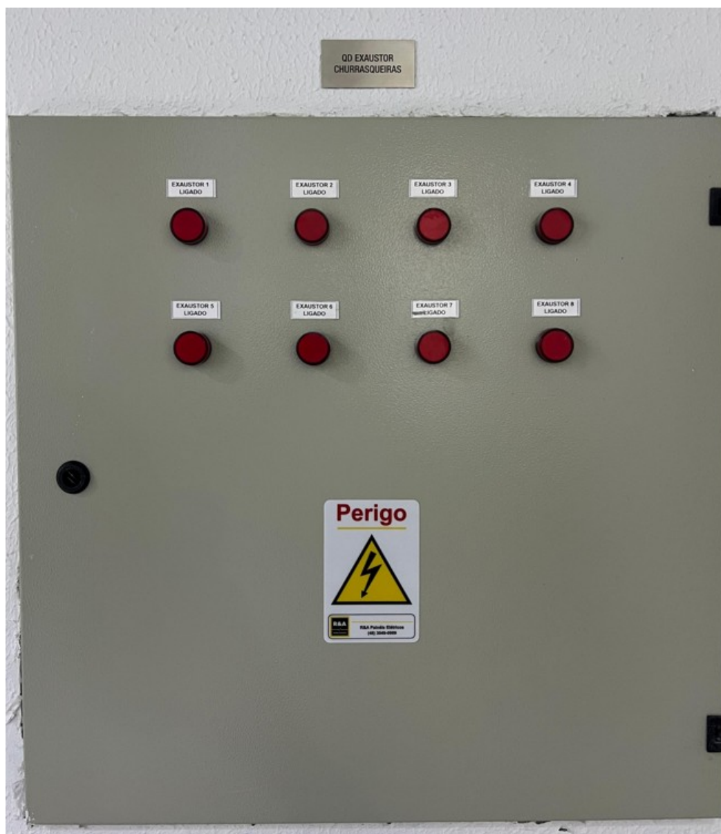
Foto quadro de comando dos exaustores das churrasqueiras
