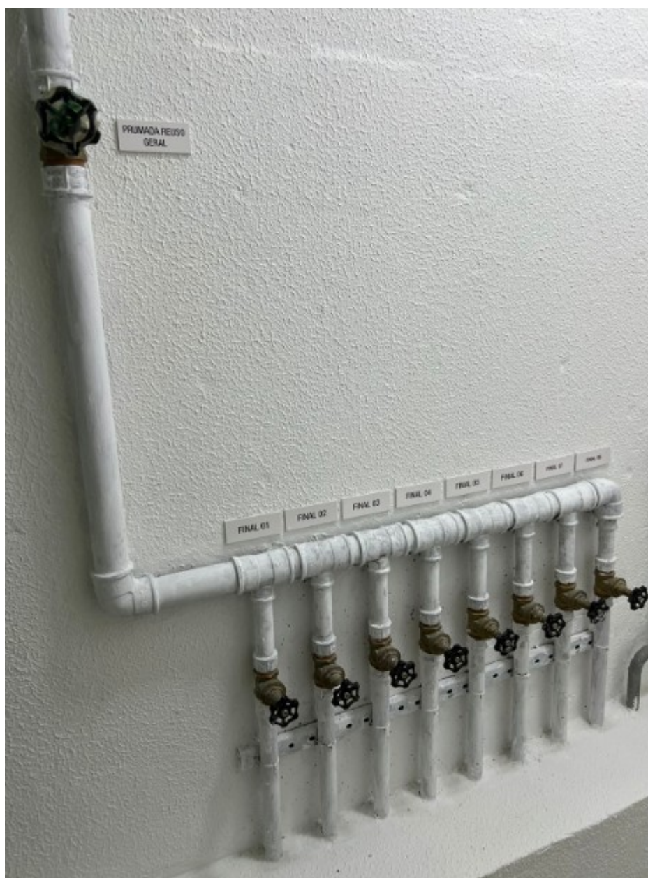
Foto – Local casa de máquinas – Registros de gaveta para controle das prumadas
